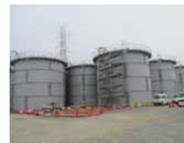
(RO濃縮水タンク)
