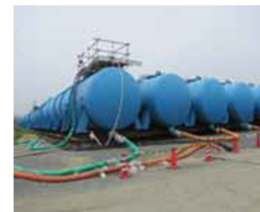
(蒸発濃縮水タンク)
