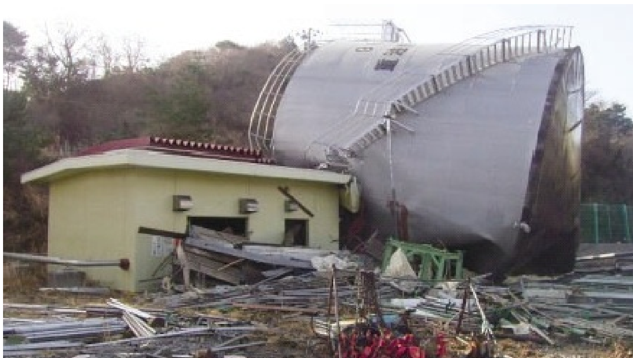
図 4.3-2 重油タンク倒壊状況
